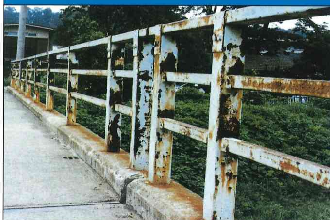
▲溶融亜鉛めっきされていない手すり（歩道橋） 施工後数年でサビがでて塗り替え補修の時期となっております。今後も数年毎に塗り替えが必要です。
