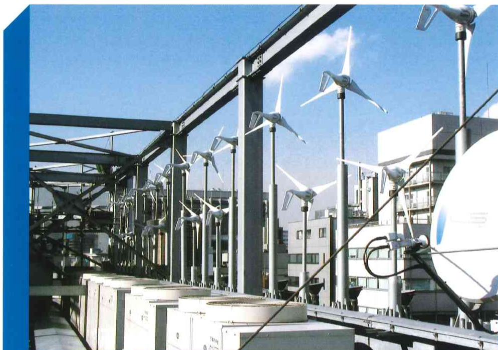
▲写真1 永代橋エコピアザビルの ビル屋上風力発電設備
