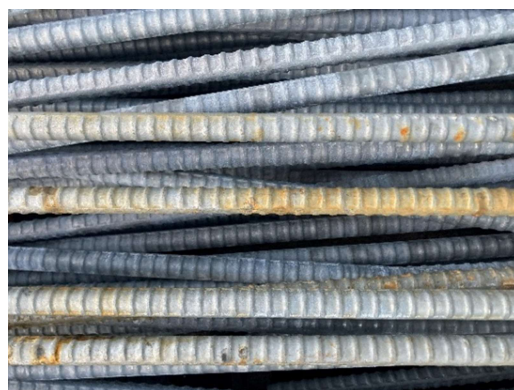
写真 4.2.4 もらい錆した鉄筋
